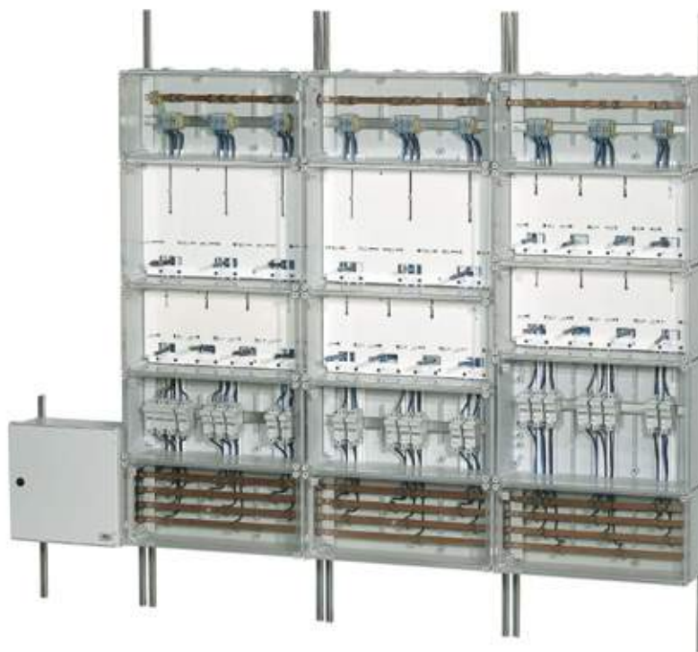
Para 16 contadores monofásicos e trifásicos e corte de 400A. Exemplo de montagem.
